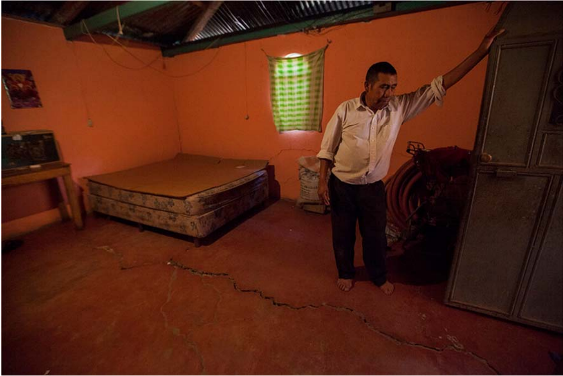
Das stark beschädigte Haus von Pedro de León
